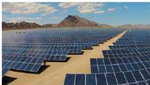
Мал. 17.7. Сонячна електростанція «Тораз», Каліфорнія, США
