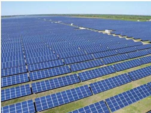
Мал. 33.8. Сонячна електростанція
