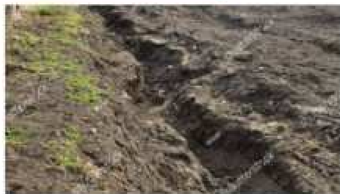
Мал. 23.4. Ерозія ґрунту
