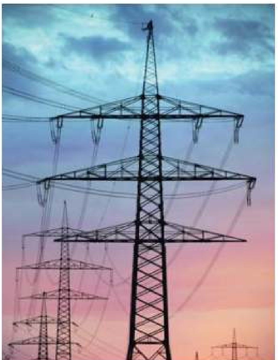
Мал. 2.6. Лінії електропередач
