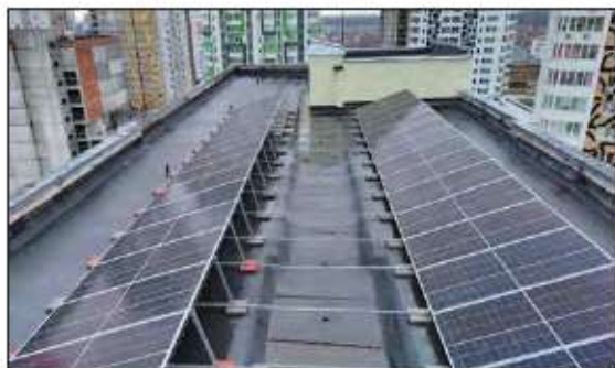
Мал. 5. Сонячна електростанція на даху багатоповерхового будинку в місті Бровари (Київська область). Сонячні панелі поглинають сонячне світло й перетворюють його на електроенергію за допомогою вбудованої системи. Батарея накопичує електроенергію, яку можна використати пізніше (ввечері або у хмарну погоду).
