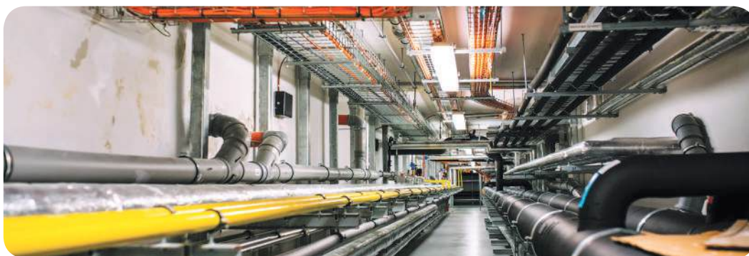
Технічний поверх багатоповерхівки
