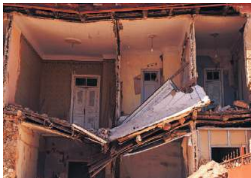
Мал. 26.1. Руйнівні наслідки землетрусу
