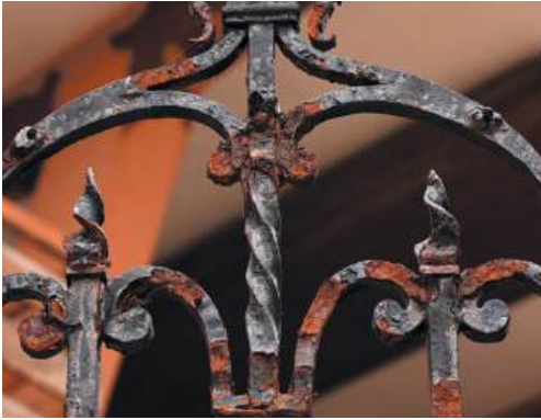
Мал. 60.4. Корозія металевої конструкції воріт
